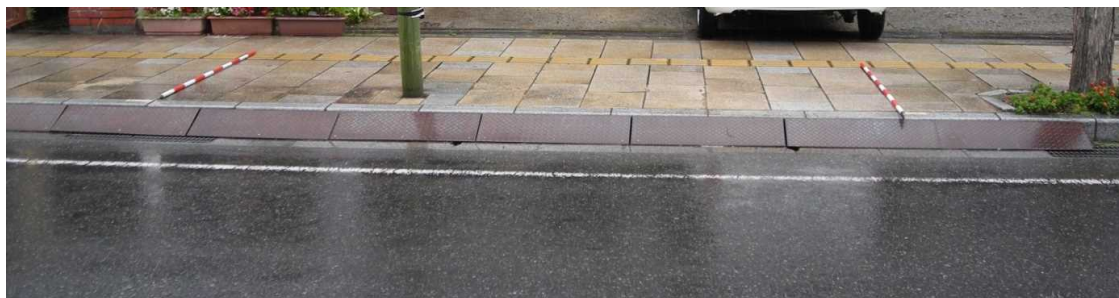
段差解消構造物設置：危険な状況
