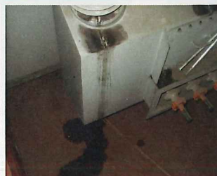
にじみ漏れの例（悪い例）
