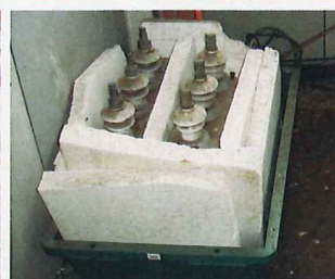
地震等による転倒防止例（パッキング材の充てん）
